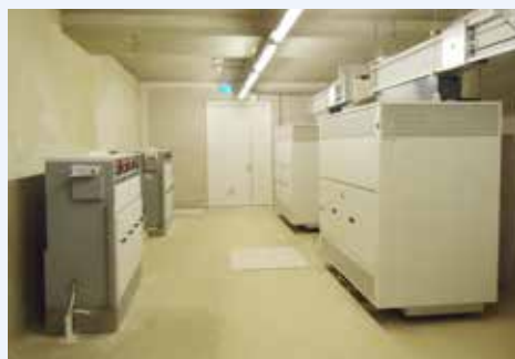
Elektrische bedrijfsruimte DSM AHEAD
