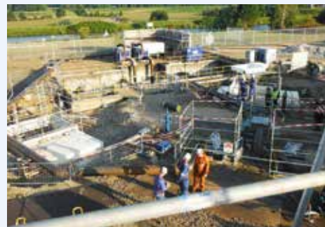
Een gedeelte van de bypassvoorziening van flocculator 1
